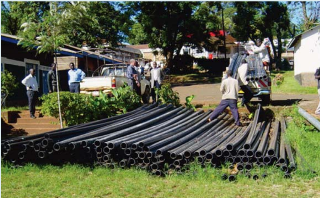
Подрядчик привез трубы для строительства водопровода в рамках проекта в Кисии, Кения. Фото@ ООН-ХАБИТАТ
